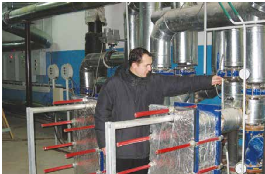
Проверка теплового пункта потребителя
